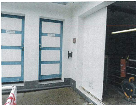
Local technique au sous-sol
